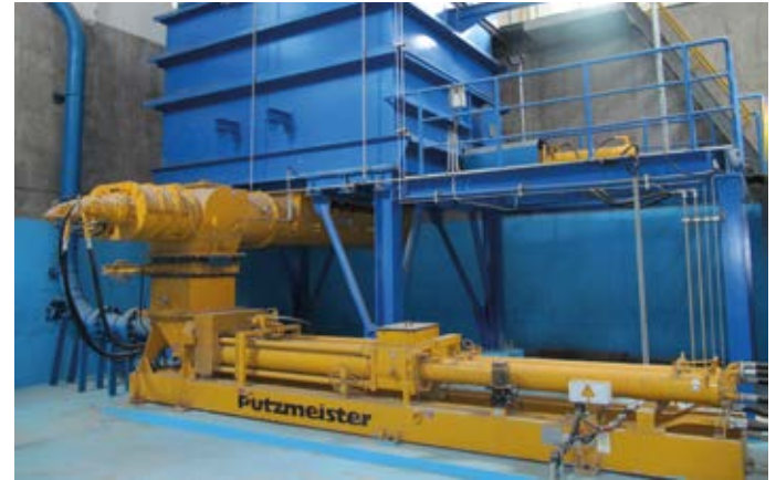
KOS mit SHS bei Heidelberg Cement Guangzhou, China
