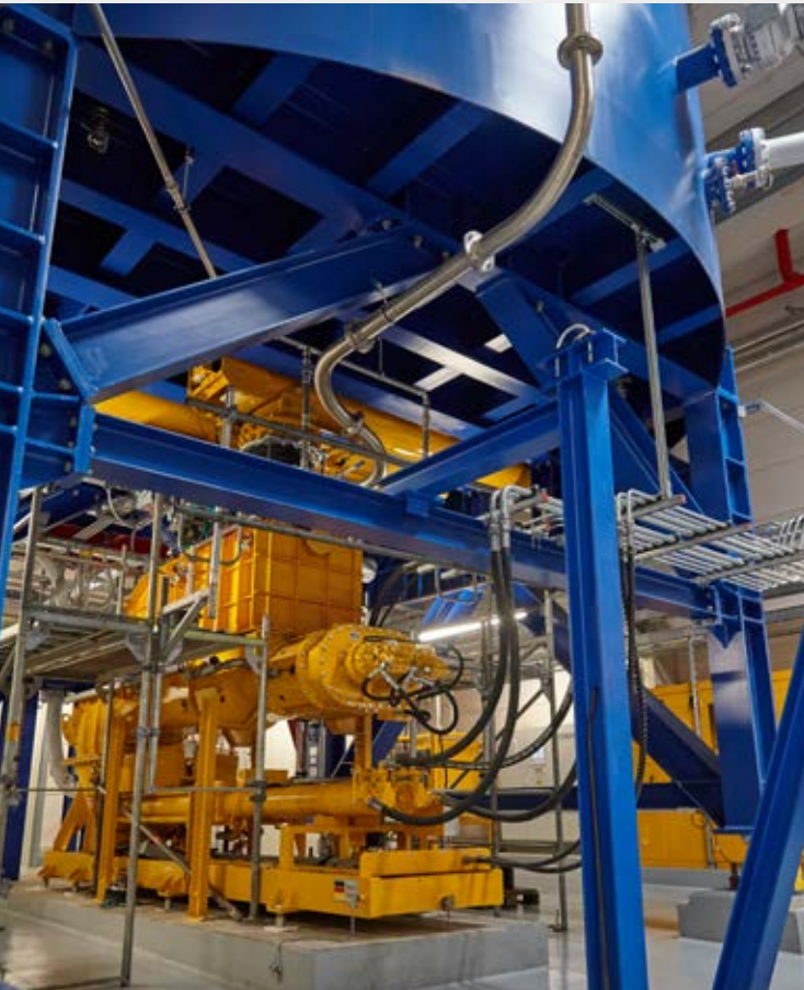
KOS im Kraftwerk Kassel
