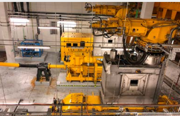
用于煤泥的KOS泵系统 (波兰Zofiówka)
