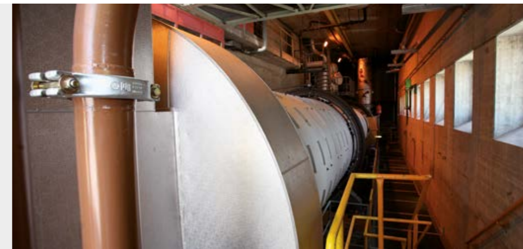
Kläranlage erzo Oftringen (Schweiz): Drehrohrofen für die Verbrennung von Klärschlamm
