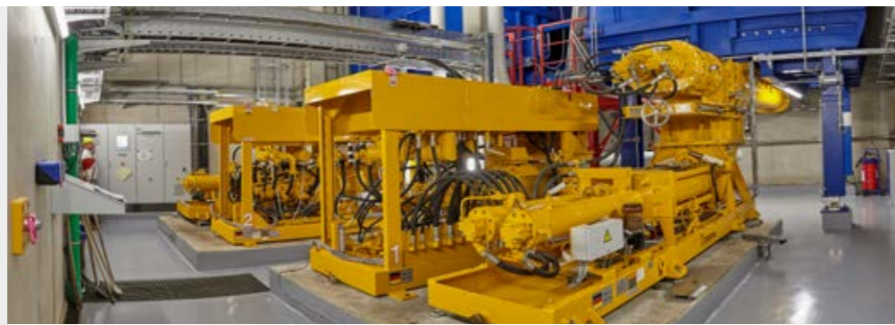
2 Klärschlammannahmebunker je 60 m 3 mit Gleitrahmenaustragssystem, doppelwelliger Bunkeraustragsschnecke, Dickstoffpumpe KOS 1080 HP
