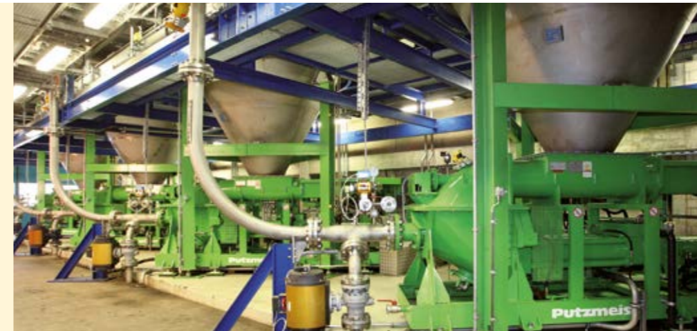
Dickstoffpumpen KOS 1050 im Klärwerk ProReno (Basel, Schweiz)
