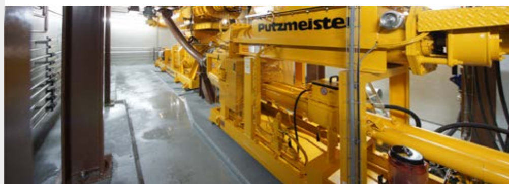
Hintergrund: KOS 1080 Kolbenpumpe unter einem 30 m 3 Annahmebunker Vordergrund: KOS 1030 Injektionspumpe zur Beschickung der beiden Ofenlinien unter einem 230 m 3 Speichersilo. Eingebaut in einen ehemaligen Müllbunker.
