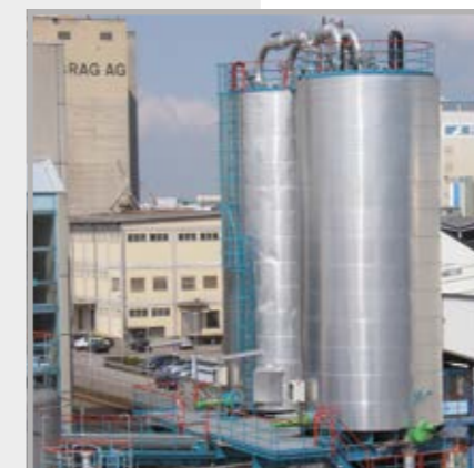
2 Stapelsilos (Isoliert) je 200 m 3 zur Bevorratung des Klärschlammes (Pro Rheno, Schweiz)
