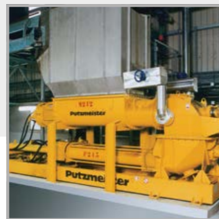
Biomüll-Recyclinganlage in Varenne-Jarcy, Frankreich: Die KOS 2180 pumpt Biomasse in eine Gäranlage
