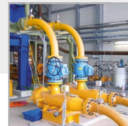
Links: Abgefangene Fremdkörper Rechts: Fremdkörperabscheider im Kraftwerk
