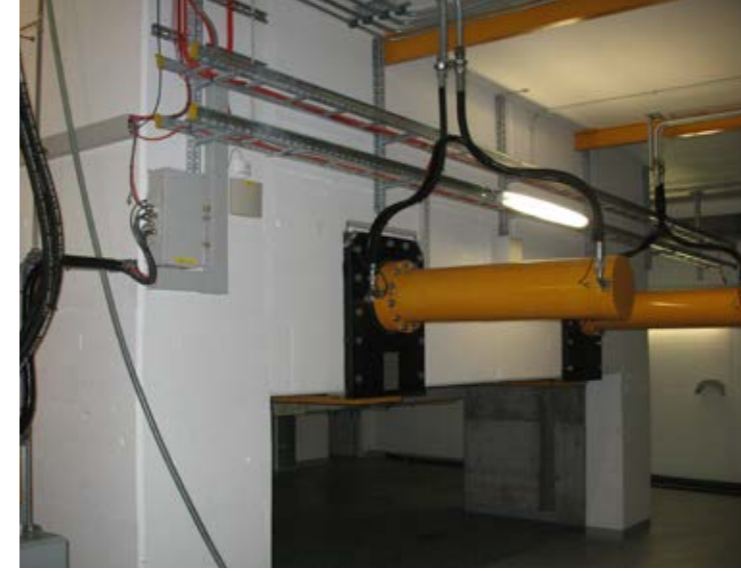
Betonarme silo içerisindeki sürgülü çerçeve silindiri, Arıtma çamuru tesisi Oftringen, İsviçre
