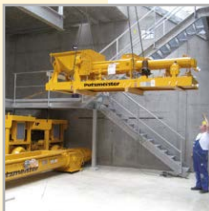
Nuova installazione presso l'impianto di trattamento acque, Neu-Ulm, Germania
