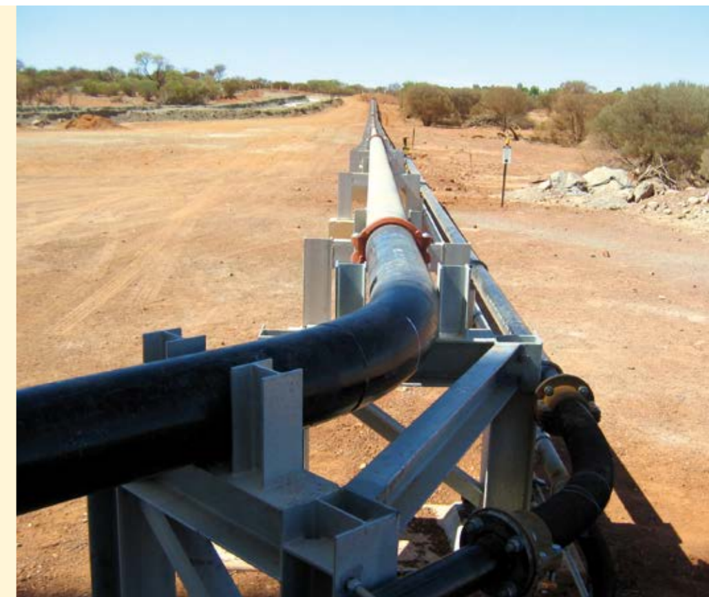
Tubulação de transporte de rejeitos
