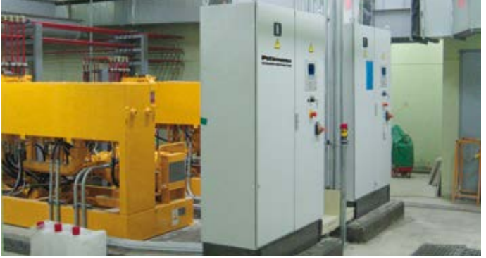
Gulpocheon (Güney Kore) atık su arıtma tesisindeki lokal kontrol paneli
