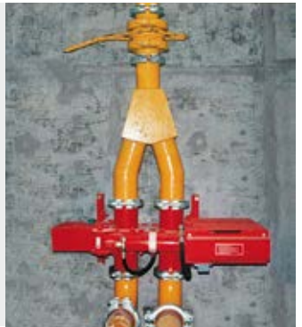
ZX 150 IP hattı kalsinatör tesisi
