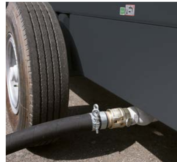
Conexión de agua libremente accesible
